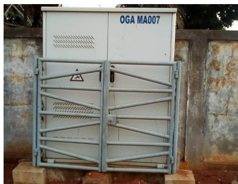
Photo 1 : Infrastructure pour internet par fibre optique
