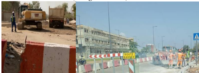
Planche 1 : Jeune maçon à Farcha/N'Djaména (image à gauche) et jeunes maçons sur le chantier à la place du souvenir à Cotonou (image à droite)
