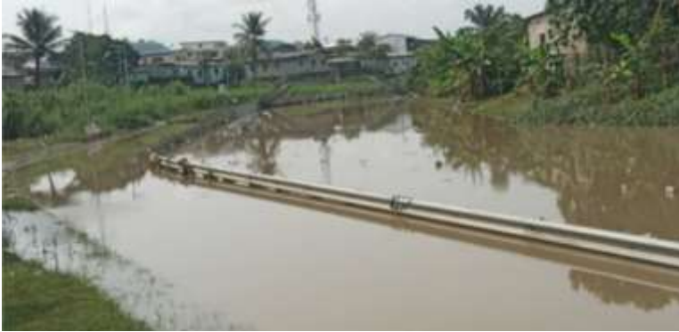
Photo 1: débordement du canal de Nzeng-Ayong
