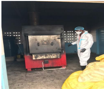
Photo 3 : Lieux d'incinération des déchets biomédicaux solides
